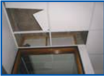
AIB fire stop over door
